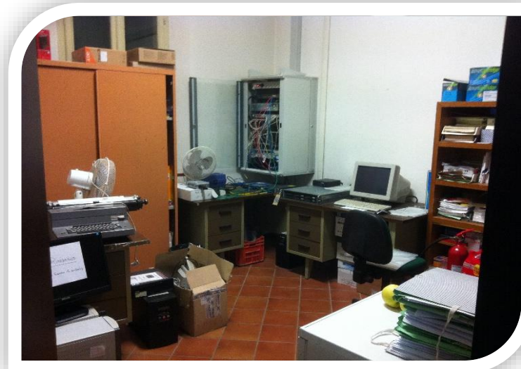
Data Center Montiano
